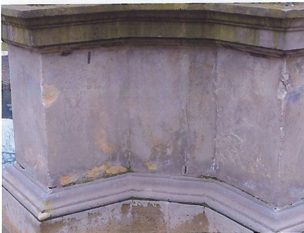
kašna se sloupem a sochou sv. Anny v Novém Městě na Moravě – detaily poškození středního podstavce
