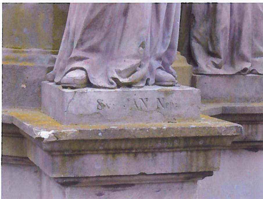
kašna se sloupem a sochou sv. Anny v Novém Městě na Moravě – detaily poškození soch
