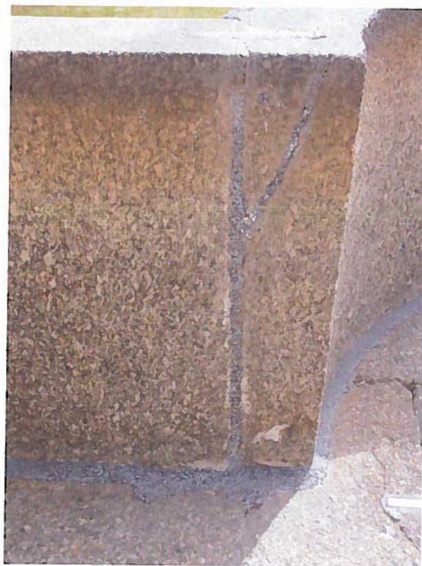
detail vnitřní stěny nádoby s narušenou spárou
