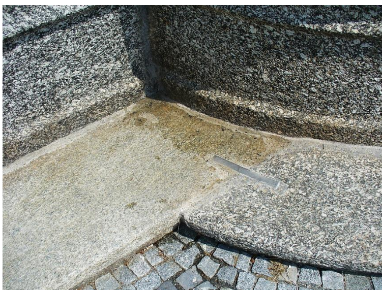
nádoba kašny – detaily drobných průsaků vně stěn kašny
