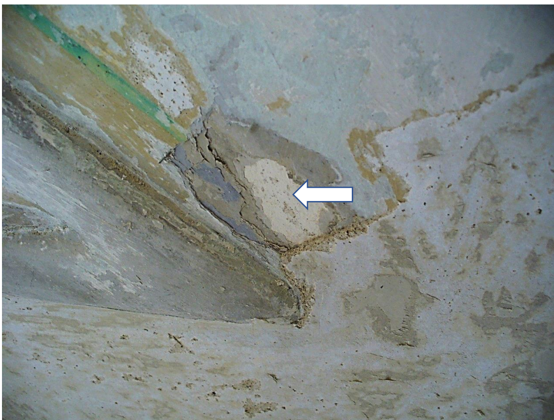
ŠTUKOVÁ VÝZDOBA –STROP, SONDY DO VRSTEV NÁTĚRŮ (ŠIPKA UKAZUJE NEJSTARŠÍ VRSTVU)
