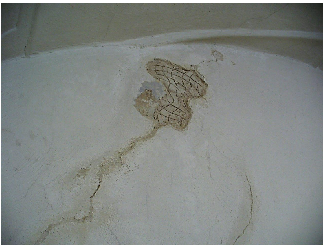
ŠTUKOVÁ VÝZDOBA – POHLED NA PLOCHY OMÍTEK S TRHLINAMI A LOKÁLNÍ VYSPRÁVKOU
