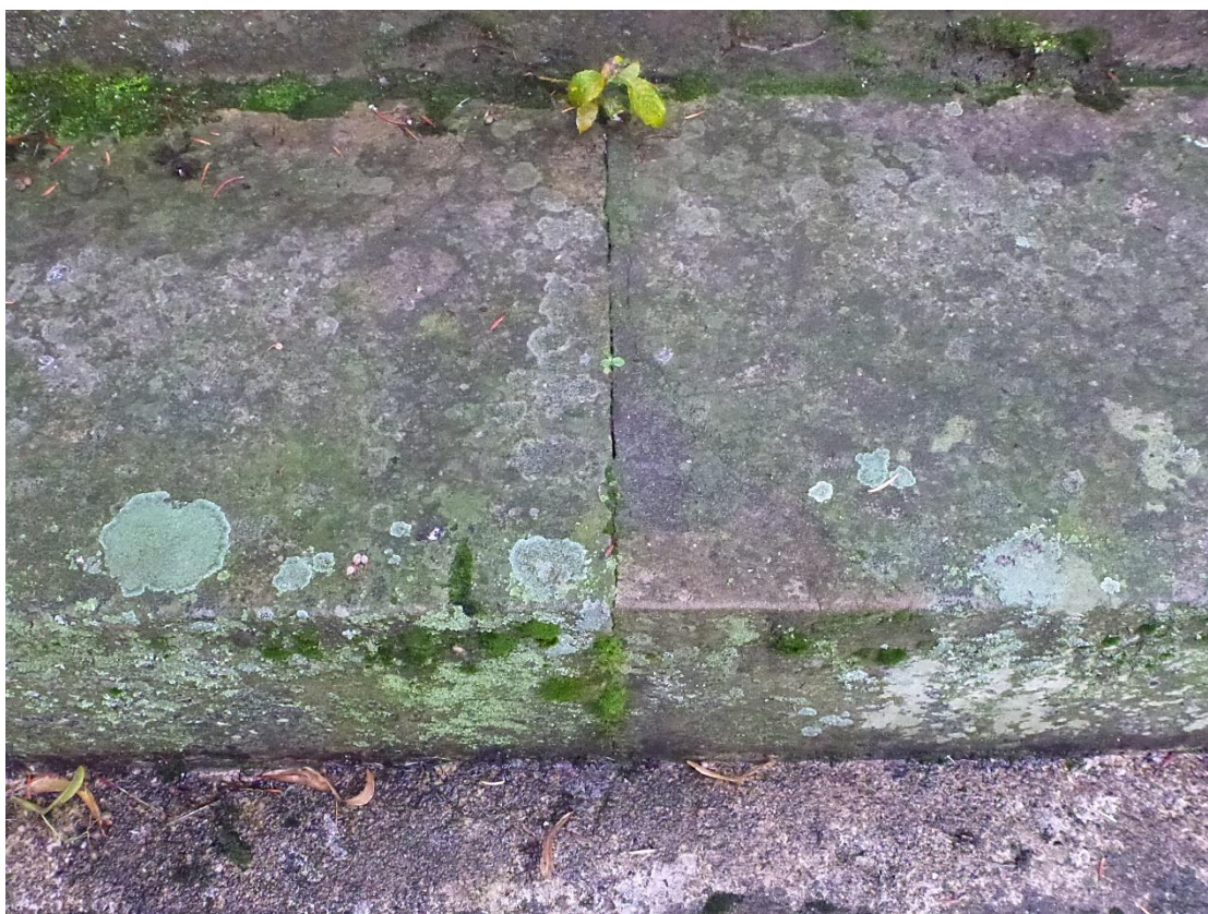
Pomník padlým vojínům – Pohřeb v Karpatech Současný stav, detail schodů, biologické znečištění, uvolněné spárování
