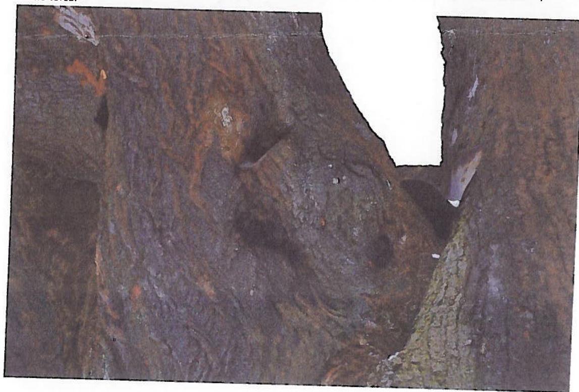
Obrázek 2 Detail úžlabí s instalovanou stříškou a plodnicemi dřevokazných hub.
